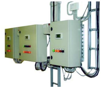
Система управления инженерным оборудованием
